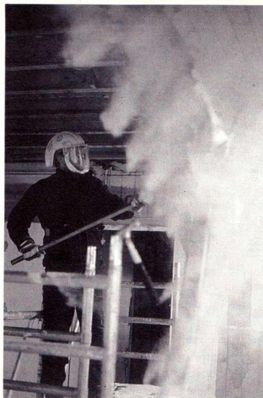
Takpanelen rivs och spånet som ligger som bjälklagsisolering rasar ut. En byggdammsugare användes i början, men det visade sig att den hade alldeles för dålig kapacitet för att klara den stora mängd spån som fanns i huset.
