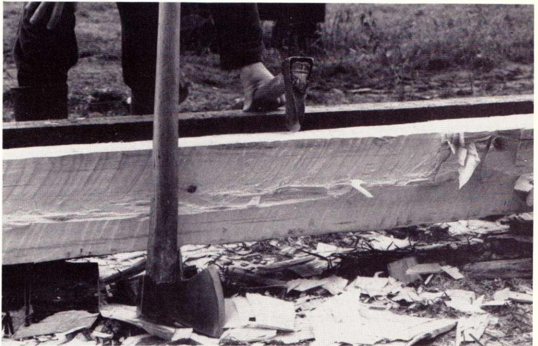
Tillverkning av en "sprättäljd" bjälke. Restaurering av kyrkoanläggning i Archangelsk. Foto: Peter Sjömar 1991. Den bilningsteknik som övergavs i Norge och Sverige vid mitten av 1300-talet levde i Ryssland kvar ända till slutet av 1700-talet. Under restaureringen av timmerkyrkor i Ryssland har den ryske arkitekten och timmermannen Alexander Popov experimenterat fram den arbetsmetod som ger den särpräglade ytan.
